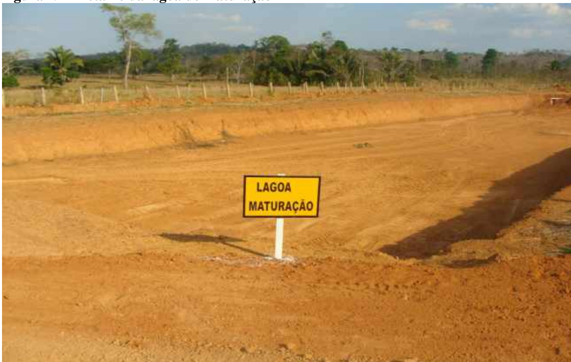
Figura 19 – Detalhe da lagoa de maturação
