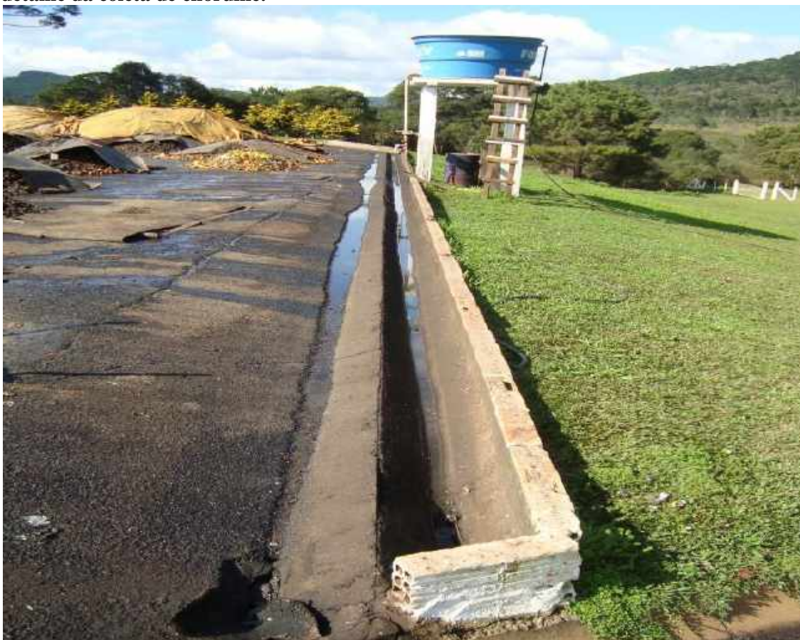
Figura 68 - Vista da canaleta de drenagem do chorume no pátio de compostagem com detalhe da coleta de chorume.
