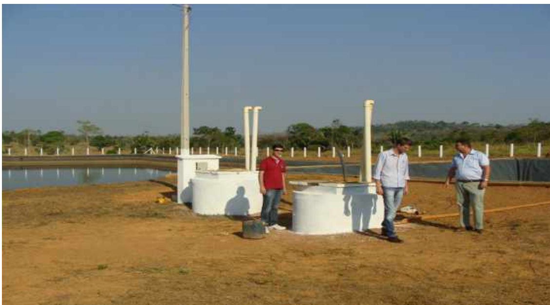
Figura 17 – Detalhe das estações de bombeamento justamente na transição das lagoas anaeróbia e aeróbia
