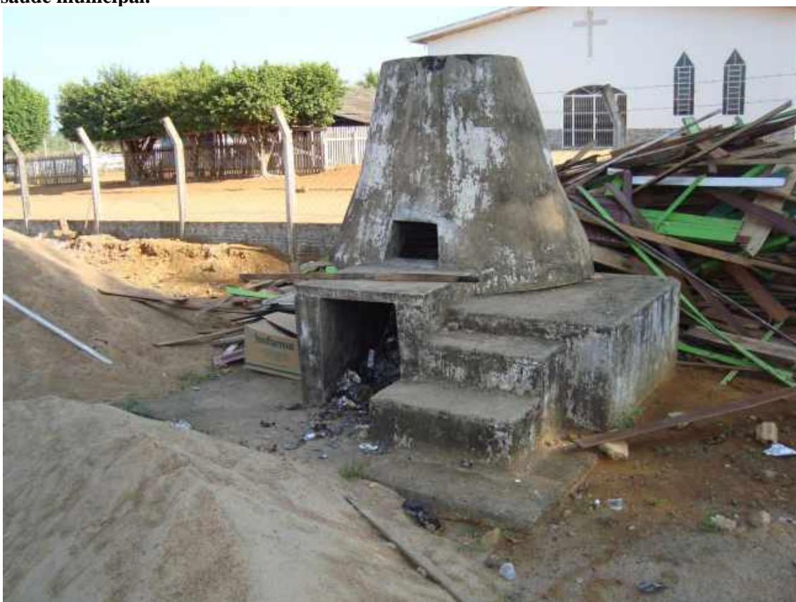
Figura 43 – Vista do incinerador do lixo hospitalar localizado nos fundos da unidade de saúde municipal.
