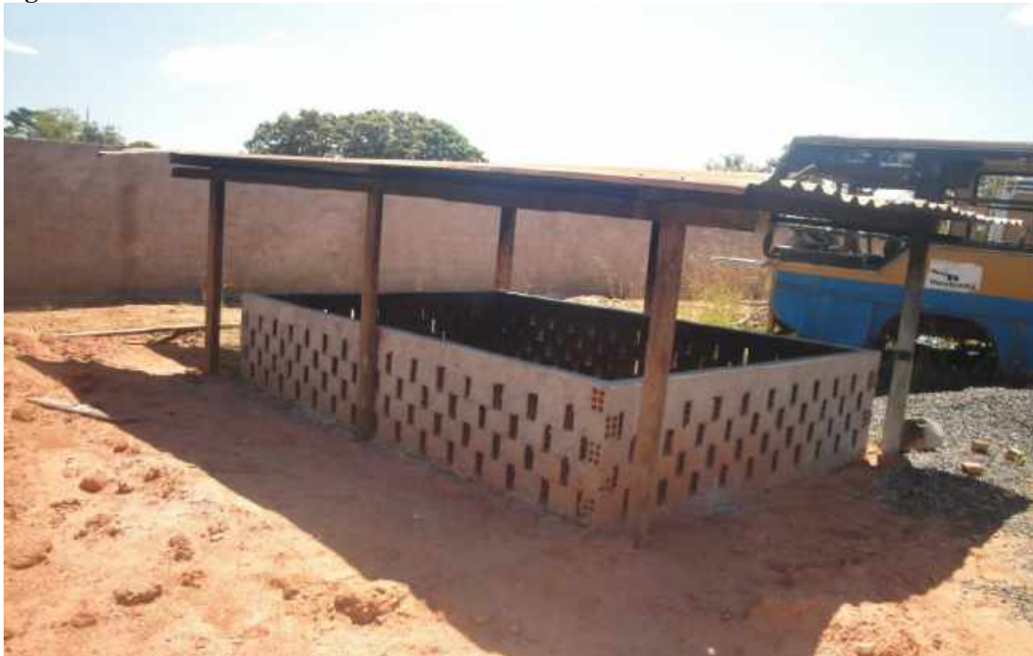
Figura 45 – Detalhe do incinerador de resíduos sólidos de saúde
